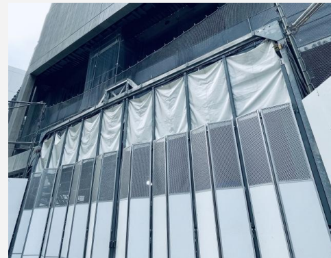
仮囲い(パンチング)
